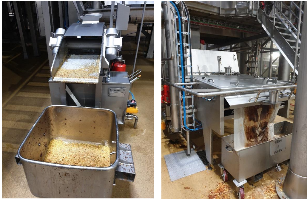
Illustration n° 29 : Croustillons et filtres papier usagés (Source : photographie du site Ecofrost sur la commune de de Peruwelz en Belgique)
