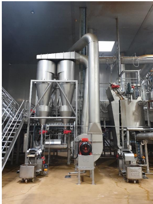
Illustration n° 28 : Installation de filtration des huiles de cuisson (Source : photographie du site Ecofrost sur la commune de Peruwelz, en Belgique)
